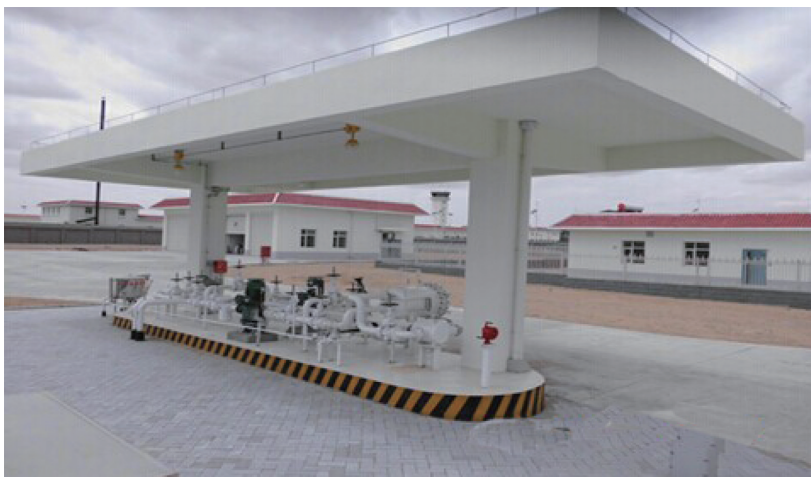
图 10.1.2-3 固原、金昌、夏河机场油库泵棚
