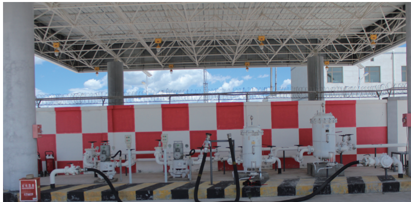
图 10.1.2-1 玉树机场油库泵棚
