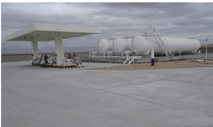
图 10.1.2-2 德令哈机场油库泵棚
