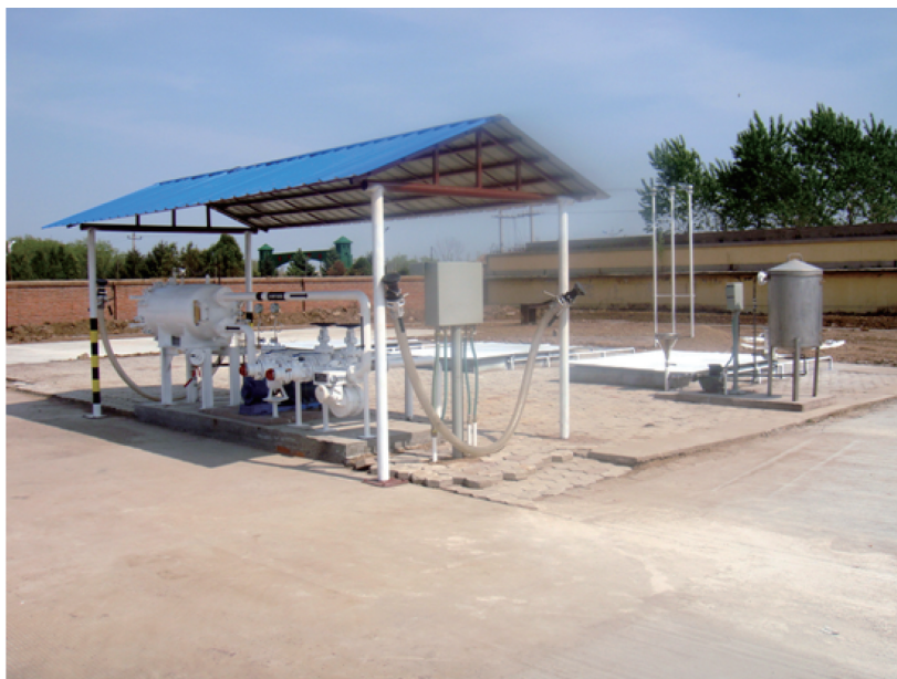
图 10.1.2-4 锦州机场油库泵棚
